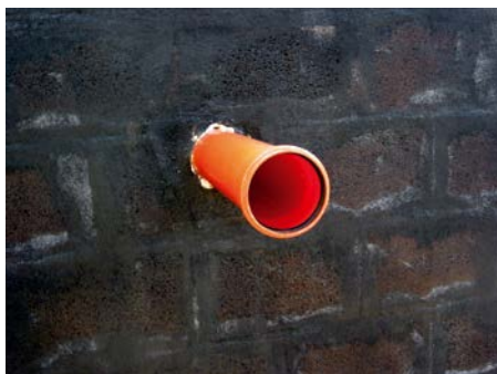
1. Труба проведена через стену с битумным покрытием.
